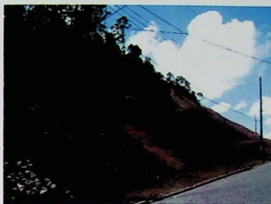
Foto 22 (PONTO 11) – Talude de corte com solo exposto próximo ao anterior. Notar presença de bloco de granito. Município: Ribeirão Pires. Foto: Cláudio José Ferreira.
