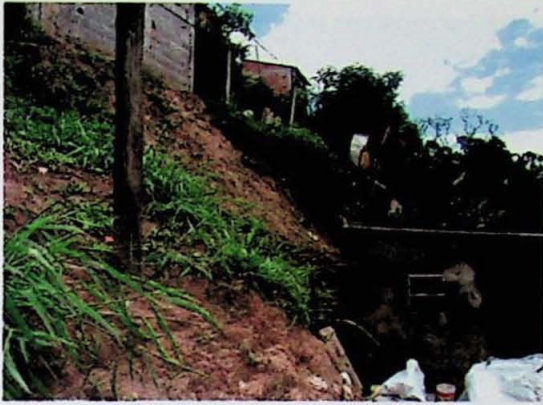
Foto 7 (PONTO 5) - Moradia encaixada em talude de corte com processos erosivos. Município: Ferraz de Vasconcelos (P4). Foto: Cláudio José Ferreira.
