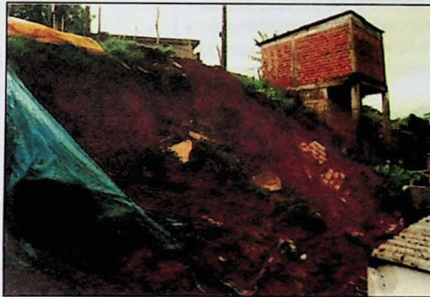
Figura 2 – Situação de risco associada a escorregamento na cidade de Suzano (SP). Fonte: Plano Municipal de Erradicação de Áreas de Risco – Suzano, 2010.
