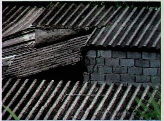
Foto 10 (PONTO 5) - Detalhe, ao centro, de trinca na parede da moradia. Município: Ferraz de Vasconcelos (P4). Foto: Cláudio José Ferreira.
