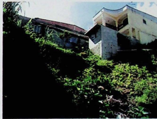
Foto 24 (PONTO 12) – Cicatriz de escorregamento próxima das casas. Presença de lixo e entulho. Município: Ribeirão Pires. Foto: Cláudio José Ferreira.
