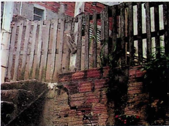
Foto 9 (PONTO 5) - Detalhe, na parte inferior, de trinca no muro da moradia. Município: Ferraz de Vasconcelos (P4). Foto: Cláudio José Ferreira.
