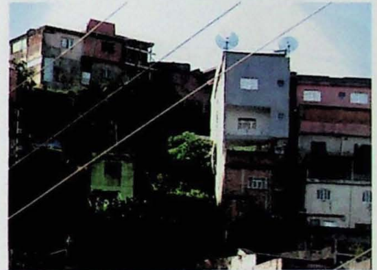
Foto 20 (PONTO 10) – Vista parcial da área anterior. Casas próximas ao talude de corte com alta declividade na parte superior. Município: Mauá. Foto: Cláudio José Ferreira.
