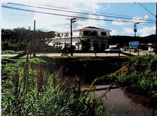
Foto 3 (PONTO 4) - Vista geral da área sujeita a inundação. Notar a entrada da tubulação da parte canalizada do córrego. Município: Ribeirão Pires (P3). Foto: Cláudio José Ferreira.
