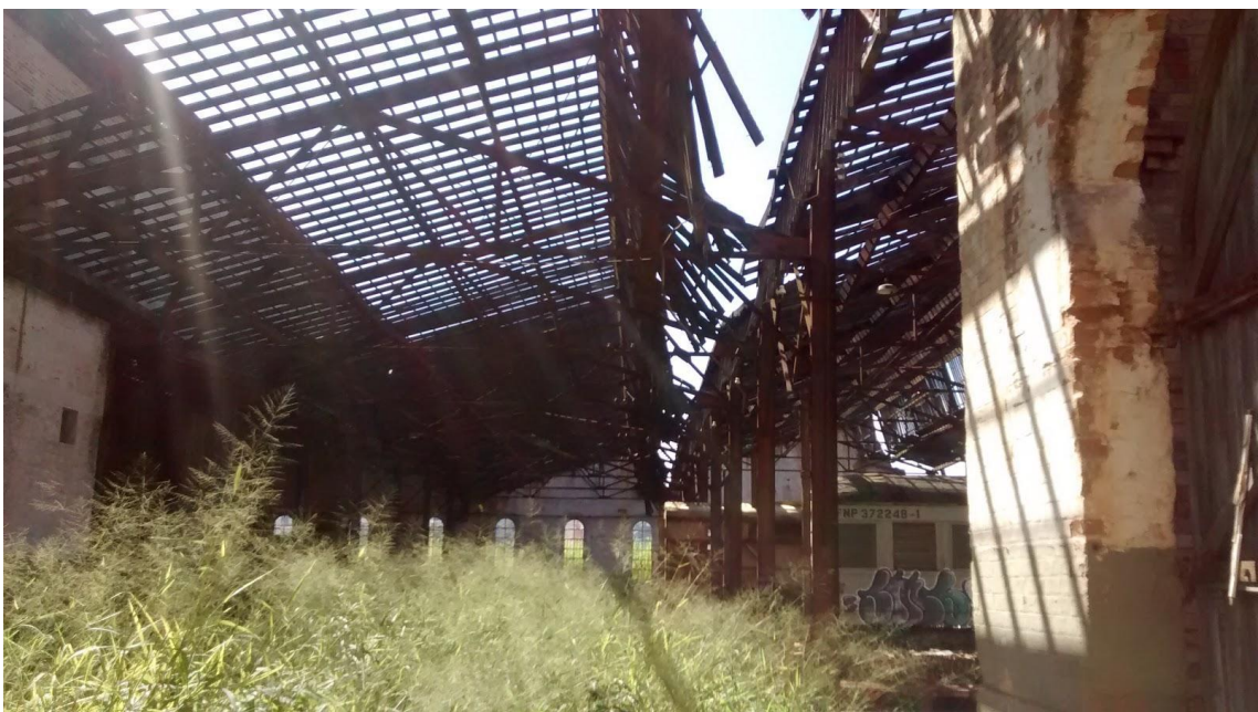
Imagem 11 - Galpões das oficinas destelhados
