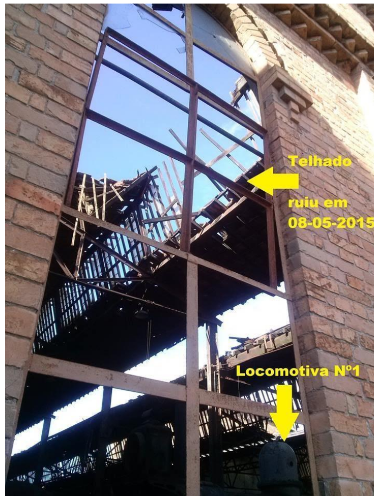
Imagem 10 - Galpão onde houve o desabamento do telhado
