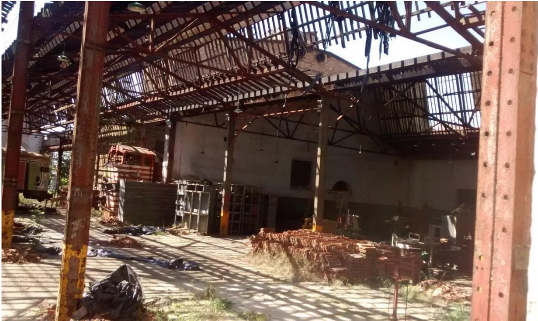
Imagem 12 - Galpões das oficinas destelhados
