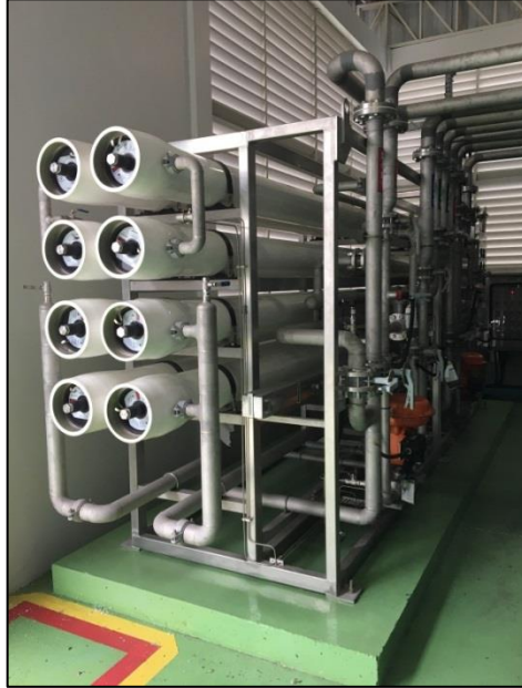
Figura 6 - Sistema de filtração por osmose reversa
