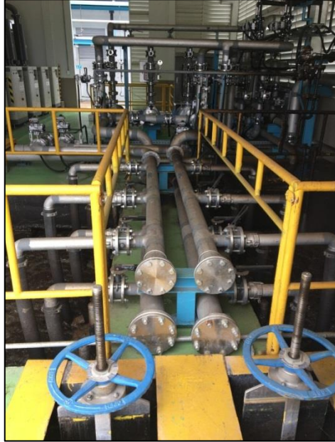
Figura 5 - Sistema de filtração MBR
