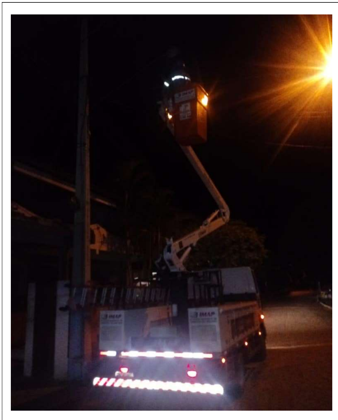
Figura 33 – Execução de serviço noturno sem iluminação.
