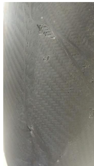
Figura 20: Maior bolha na superfície externa (Fonte: Autor, 2017)
