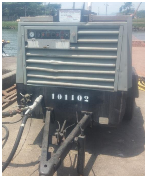
Figura 14 -. Compressor de Ar
