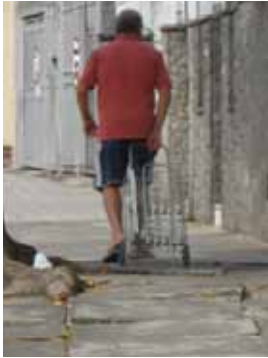
Figura 103. O piso está todo danificado, dificultando a passagem dos pedestres com seus equipamentos de transporte.
