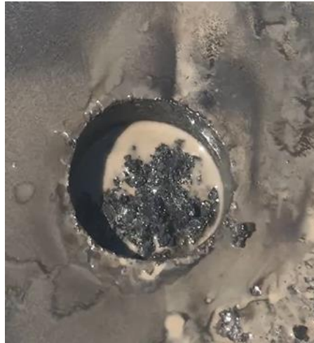
Figura 96 - Defeito criado no pavimento
