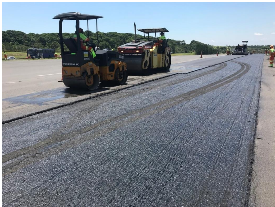
Figura 104 – Marcas de pneus sobre a pintura de ligação, mostrando a retirada da camada ligante
