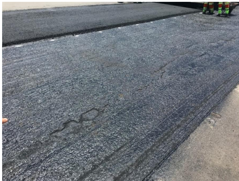
Figura 101 - Superfície não uniforme após fresagem a frio
