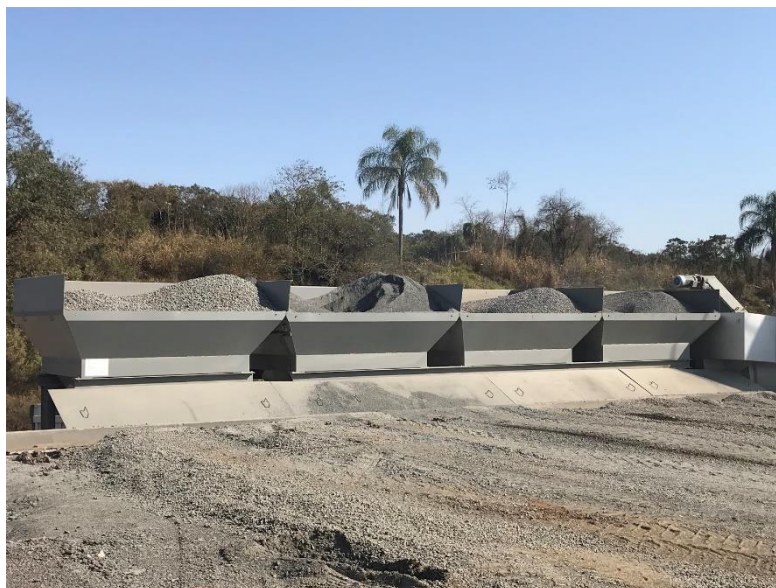
Figura 31 - Silos da usina móvel
