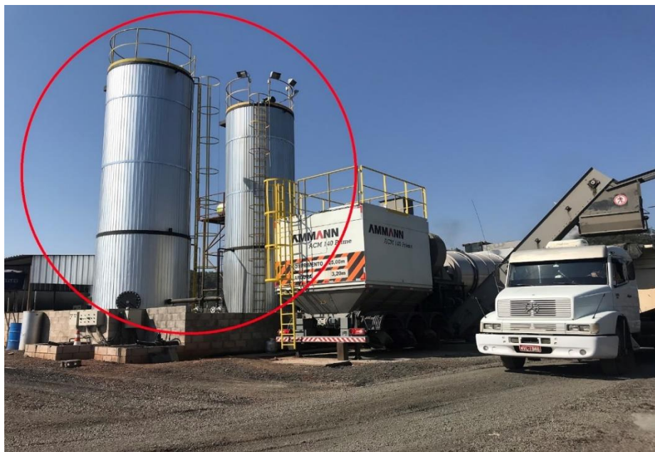
Figura 32 – Tanques de armazenamento de CAP
