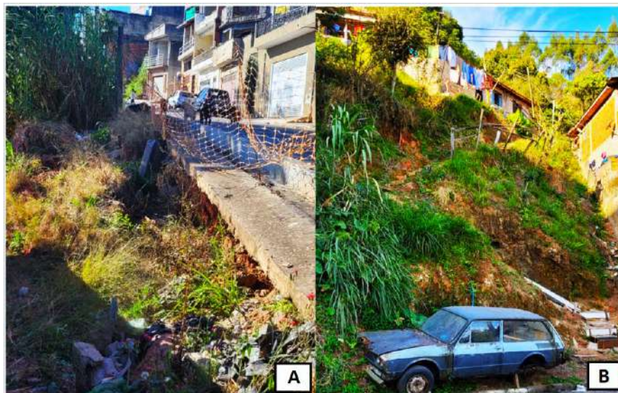
Figura 16– (16A) Degrau de abatimento em setor com grau de risco muito alto; (16B) moradia de baixo padrão construtivo a 1m do topo do talude de corte, município de Santa Isabel-SP. Fonte: Elaborado pelo autor.
