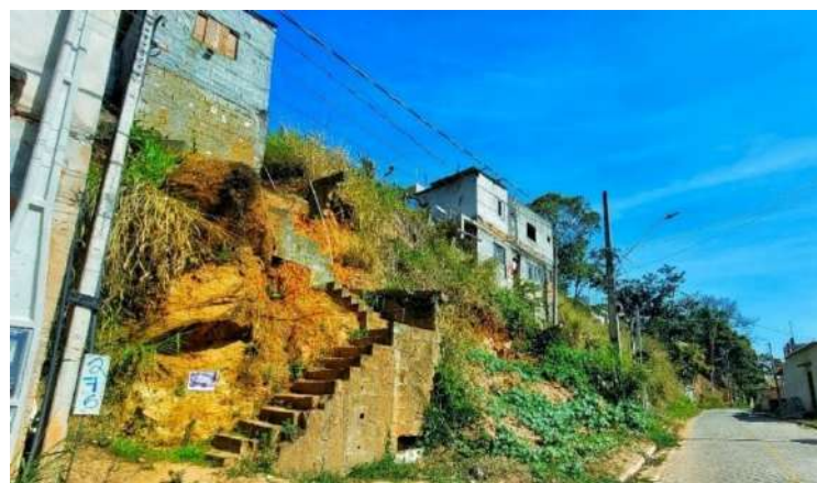
Figura 7 – Moradias no topo do talude de corte em Guararema-SP, agosto de 2022. Fonte: Elaborado pelo autor.
