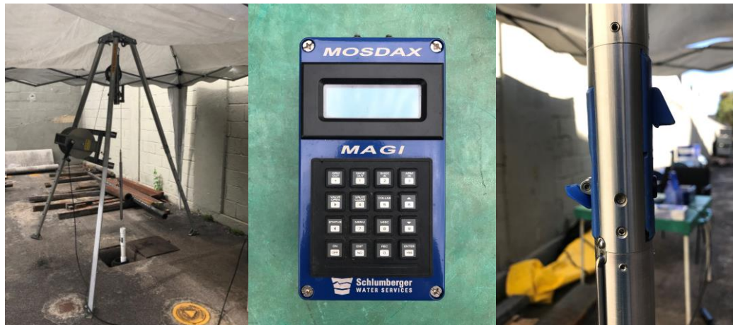
Figura 11. À esquerda, tripé e polia com a sonda MOSDAX Sampler Probe posicionada sobre a boca do poço Westbay; ao centro, interface MAGI – MOSDAX Automated Groundwater ; à direita, detalhe dos apoios mecânicos na sonda para encaixe dentro do poço.
