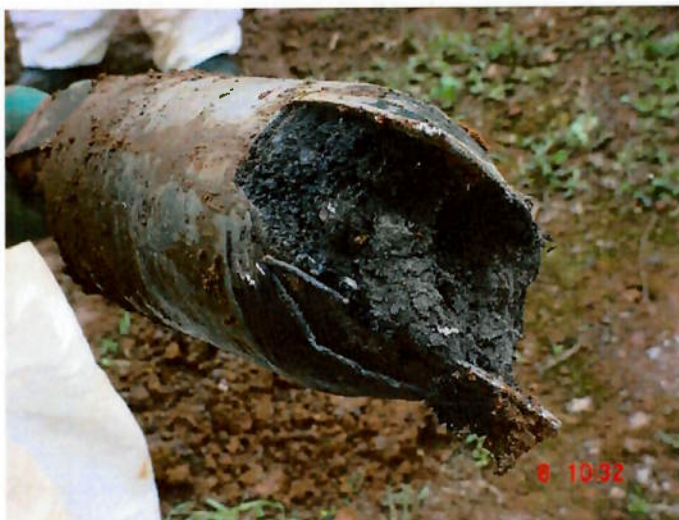
Foto 4: Presença de solo contaminado
