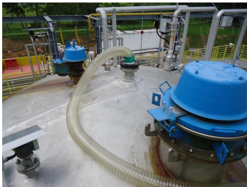
Figura 26 - Mangueira de Scrubber conectada no tanque de Ácido Fórmico.
