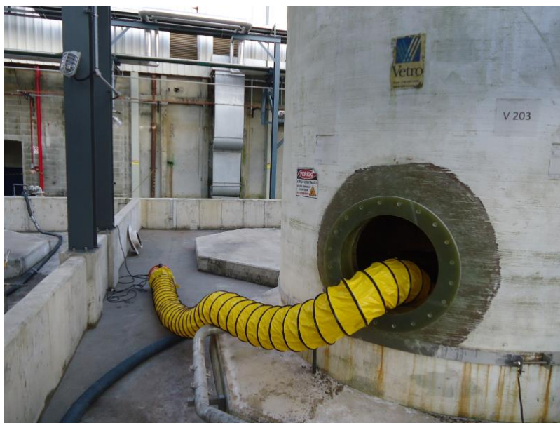
Figura 13 - Equipamento de exaustão de ar colocado na BV do Tanque de XB.
