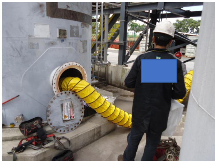
Figura 22 - Equipamento de exaustão colocado no Tanque de Óleo de soja.
