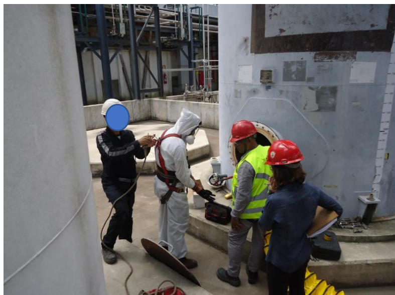
Figura 24 - Equipe envolvida na atividade de Espaço Confinado do Tanque de Óleo de Soja
