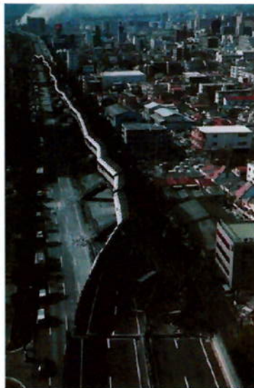
Figura 1.1 - Ponte da cidade de Kobe, caída devido ao não resistir abalos sísmicos.
