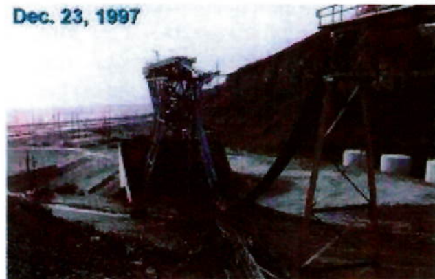
Figura 1.4 - Fratura frágil por concentração de tensão por solda.
