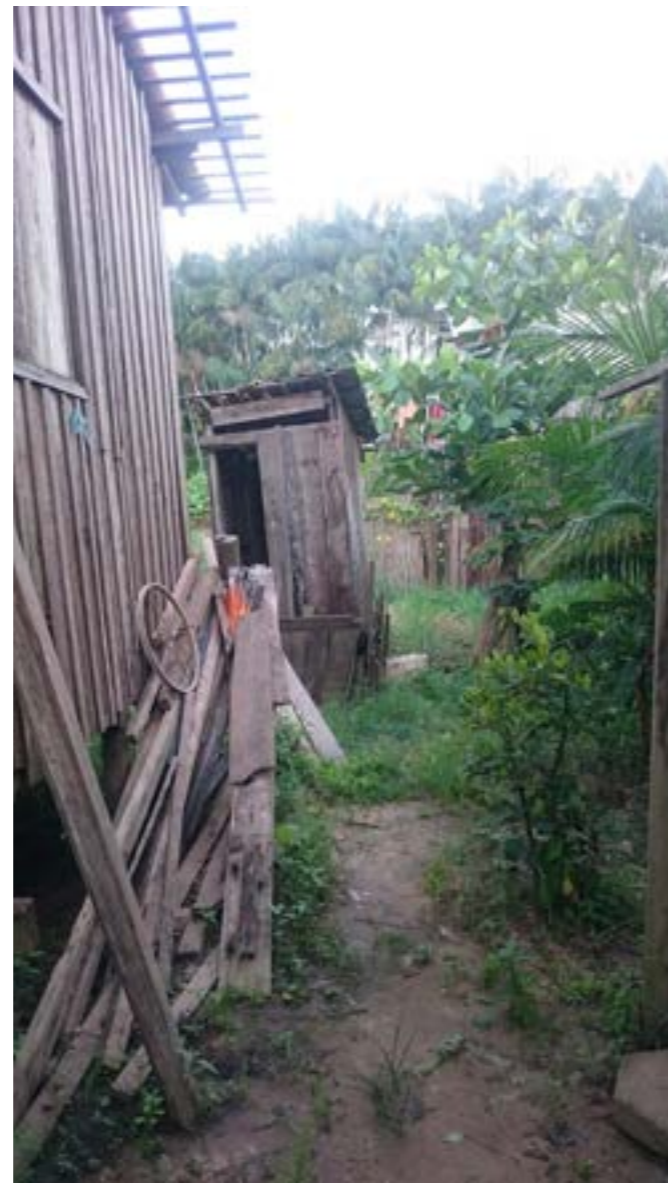
Figura 18: Construção precária em madeira localizada em área de igarapé no Bairro Alto, à direita tem-se a área da cozinha e do quarto, à esquerda, a “instalação sanitária” sem fossa séptica.
