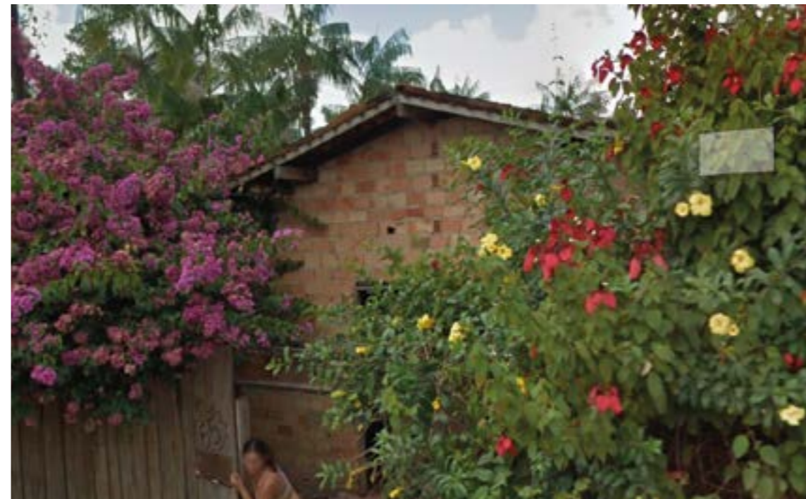
Figura 34: Casa localizada nas proximidades da área abordada no Caso 1 - Ausência do uso da verga na instalação da porta.
