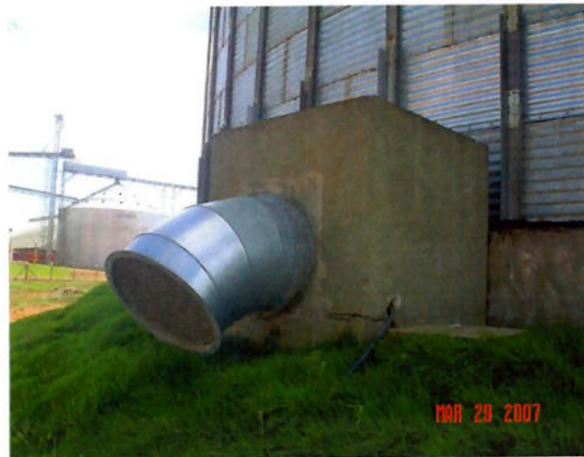
Figura 25 – Saída do exaustor do túnel do silo
