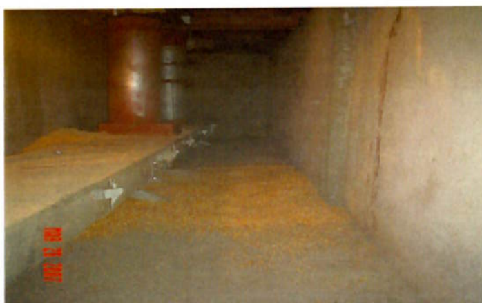
Figura 20 – Falta de limpeza no túnel
