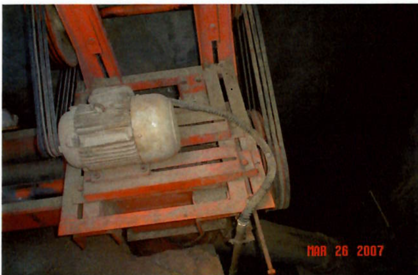
Figura 22 – Falta de proteção das correias de acionamento do motor
