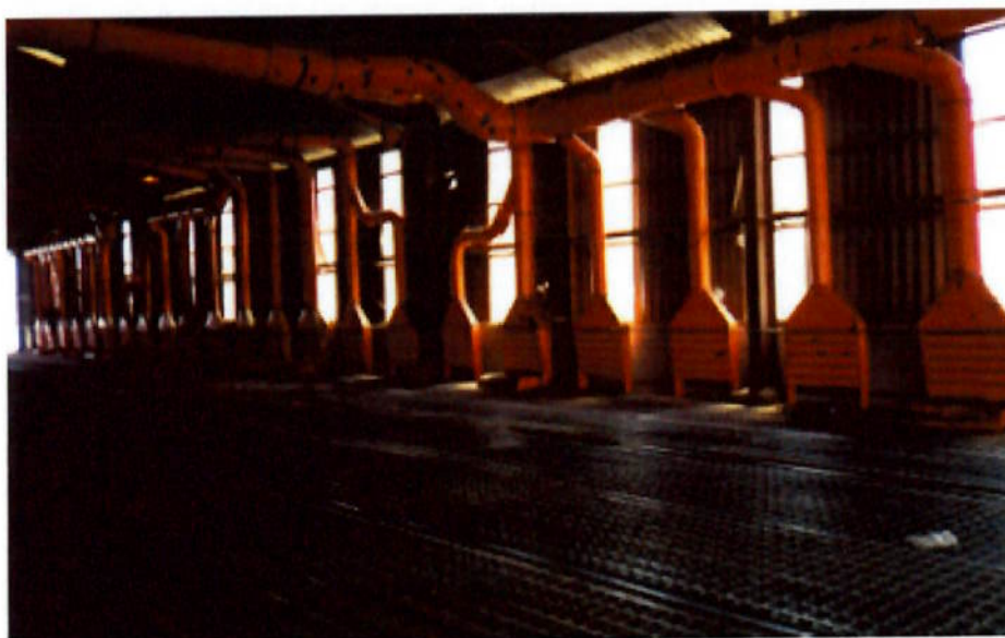
Figura 13 - Aspiração de pó na descarga de moegas ferroviárias
