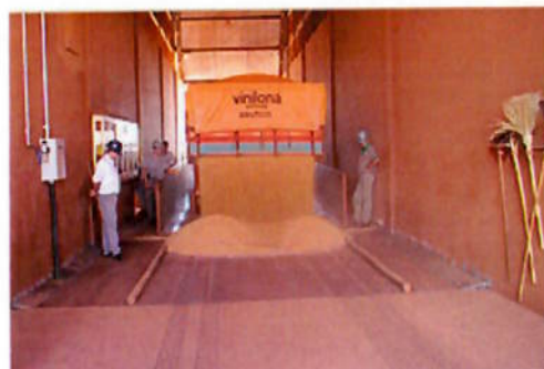
Figura 31 – Moega com captação de pó
