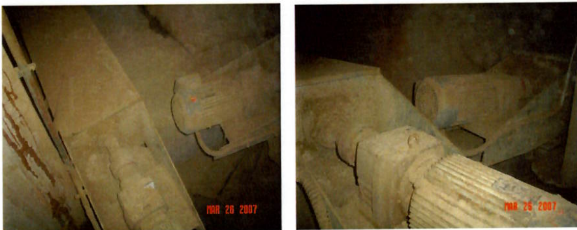
Figura 21 – Acúmulo de pó sobre os motores
