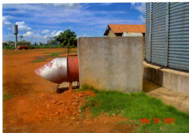
Figura 26 – Exaustor do final do túnel silo pulmão e moega
